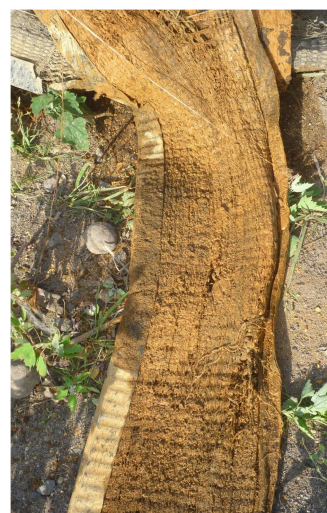
写真1 崩落箇所から採取した裏面排水材の状況
