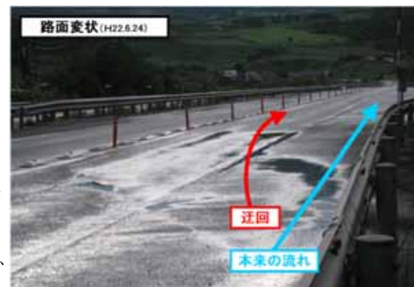
図-5 路面の不陸による滞水状況
