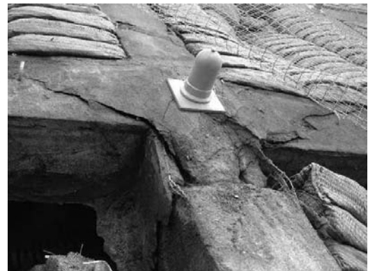
写真-3 地山補強土工の被害事例 1)
