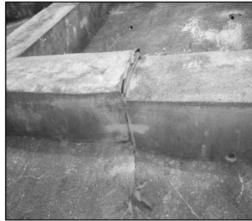
図-6 受圧板 変位箇所
