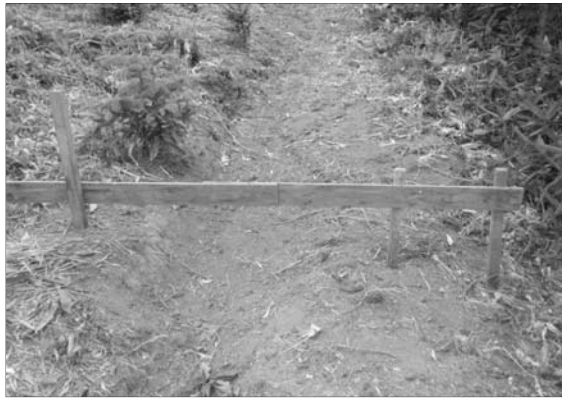
図-5 のり肩クラック
