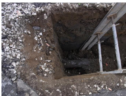
写真-1 埋設パイプラインの例 (ガス支線)
