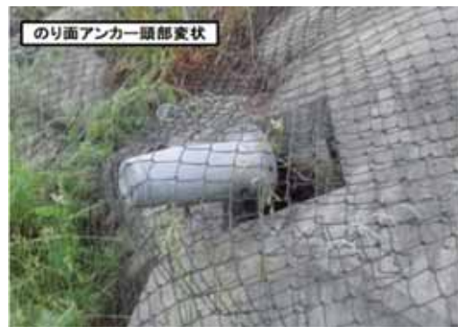
図-7 アンカーキャップの突出状況
