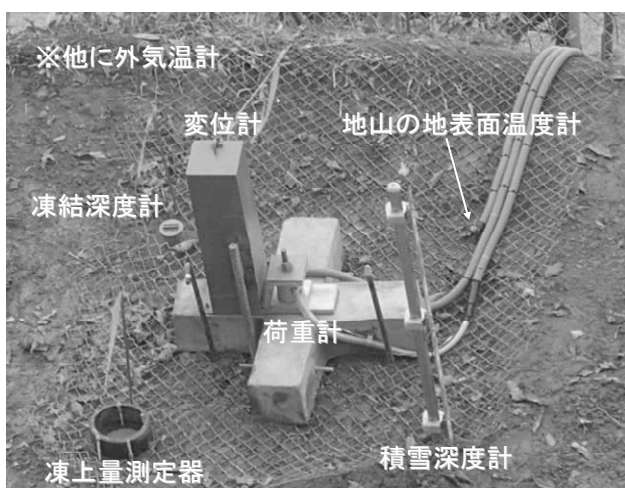
写真-5 白糠②の計測器の設置状況
