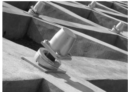
写真-2 グラウンドアンカーの被害事例②
