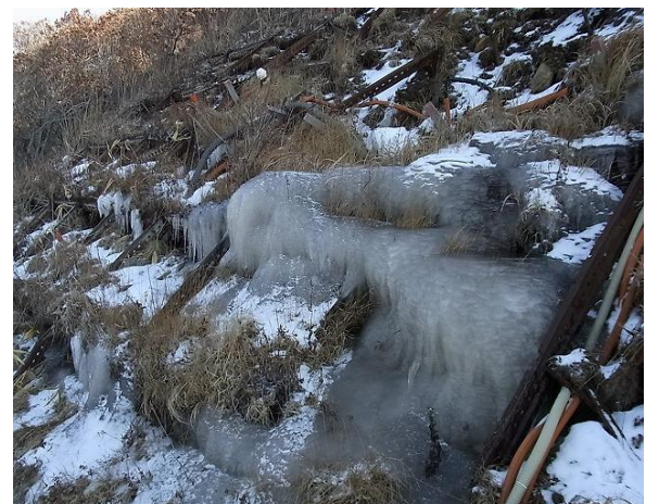
写真-5 斜面表層の凍結状況
