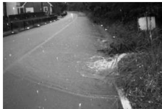
写真-1 道路側溝のオーバーフロー状況
