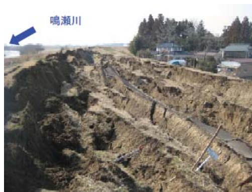
写真-1 東北地方太平洋沖地震における河川堤防(鳴瀬川)の被災状況 1)
