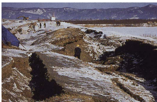
写真-2 1993年釧路沖地震における河川堤防(十勝川統内築堤)の被災状況 2)
