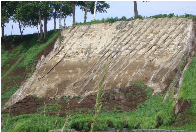
写真1 崩落後の様子
