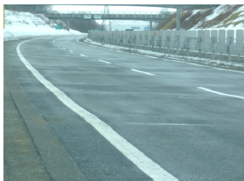
写真-1 路面不陸の発生状況
