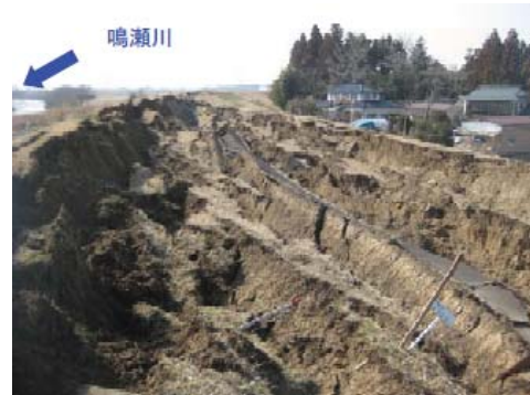
写真－1 東北地方太平洋沖地震における河川堤防（鳴瀬川）の被災状況 1)
