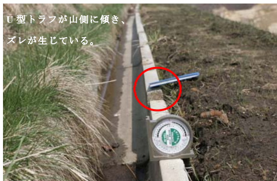
写真-2 切土法面の小段の凍上被害
