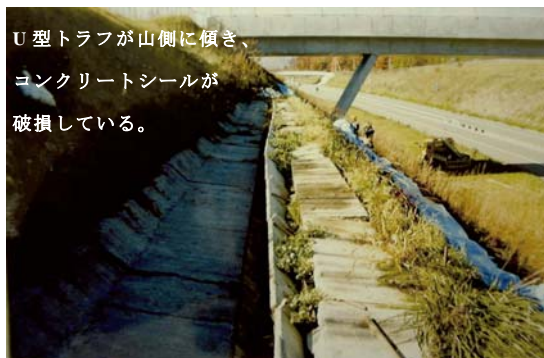
写真-1 切土法面の小段の凍上被害
