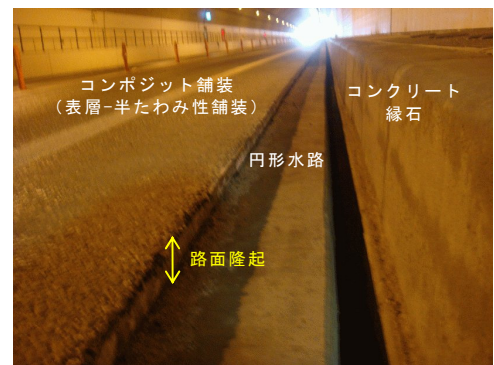
写真2 トンネル内の路面隆起
