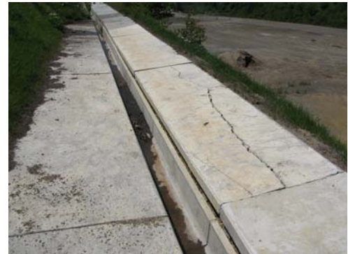
写真-1 切土小段の凍上被害 1
