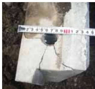
写真-6 壁面の破損状況(A-2)
