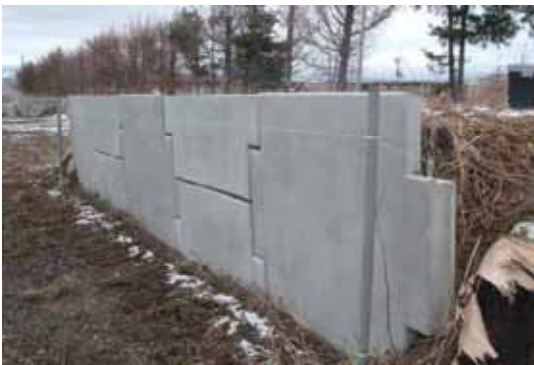
写真-4 壁面の変形状況(A壁西向き)
