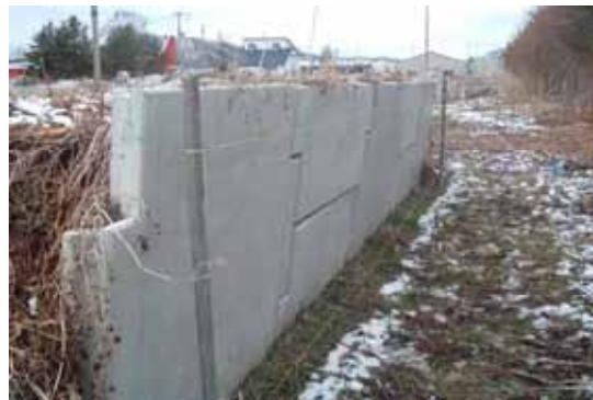
写真-5 壁面の変形状況(B壁東向き)
