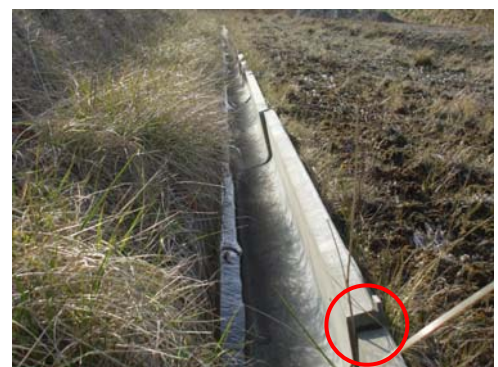
写真-2 切土小段の凍上被害 2
