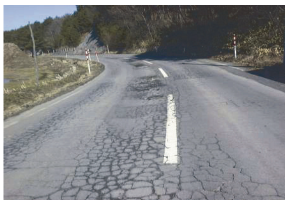
写真-5.1 舗装路の凍上被害例 1)
