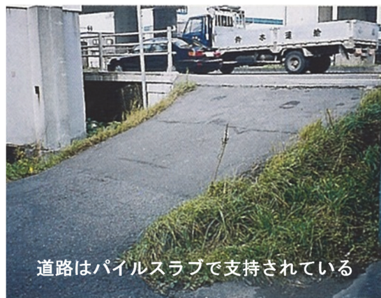
写真-6.1 住宅地と道路との不同沈下 (段差)
