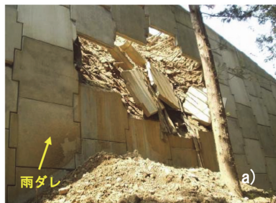
補強土壁の崩壊 5)
