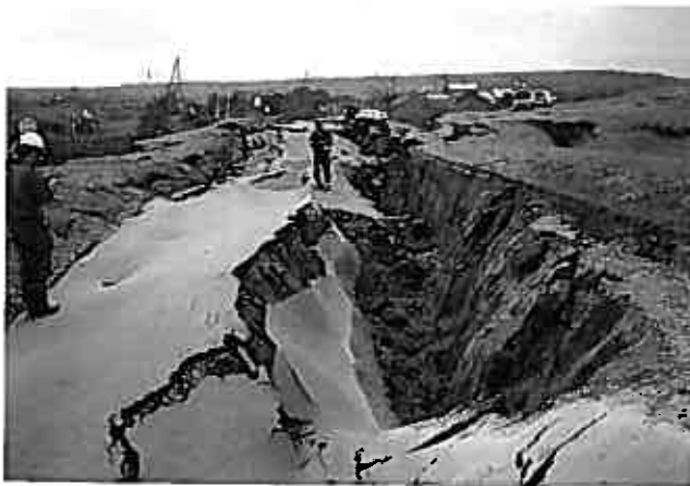
写真-4.1 平成 15 年十勝沖地震における大津築堤取付道路の被災状況(河口から 3.5km 付近) 池田河川事務所資料
