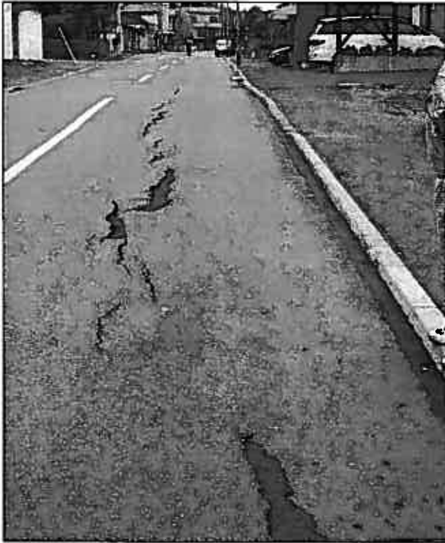
写真-4 道路の亀裂と沈下
