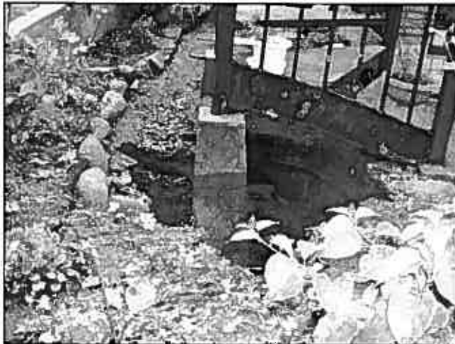
写真-5 家屋の基礎地盤の沈下
