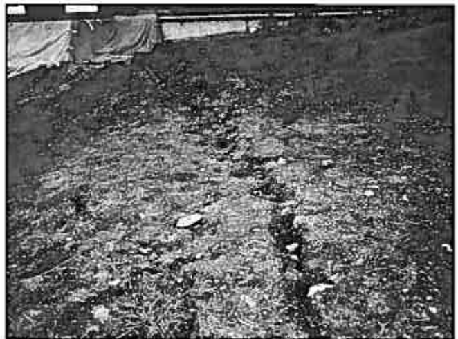
写真-3 家屋の基礎地盤の亀裂
