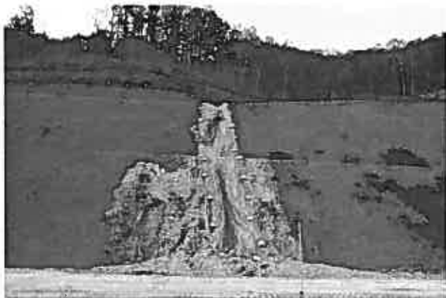
写真-1 被災事例①
