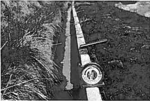
写真-17 凍上でずれた側溝
