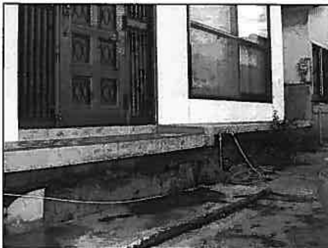
写真-6 家屋の基礎地盤の沈下
