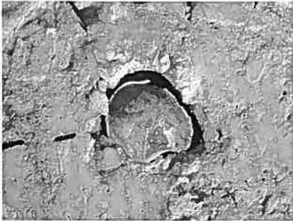
写真-2 試験後の孔壁の状態 (孔内水平載荷試験)
