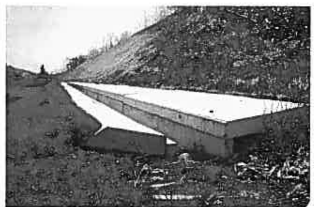
写真-16 凍上でずれたコンクリートシール
