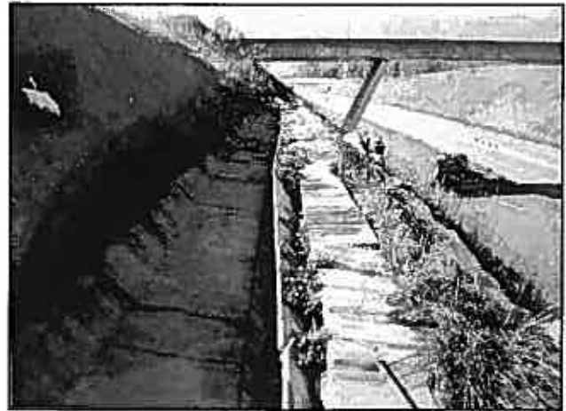
写真1 小段排水工の凍上被害状況
