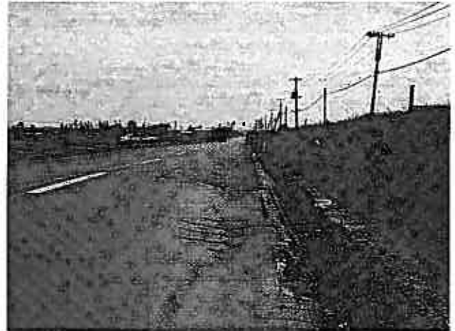
写真-1 引き込み沈下の被害例
