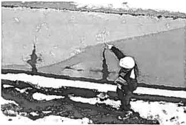
写真-1 函体クラック発生状況（田中樋門）
