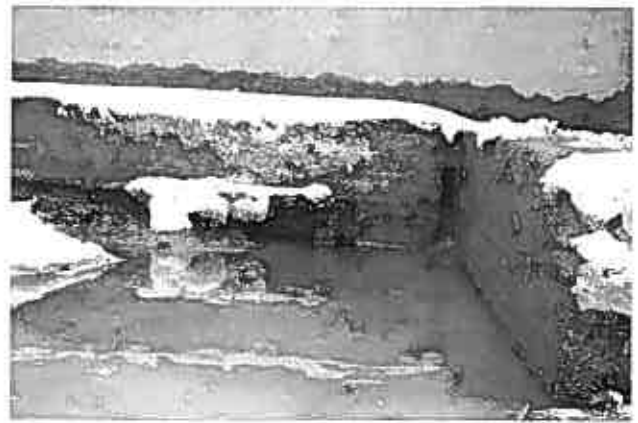
写真-2 函体底版下の空洞化（田中樋門）
