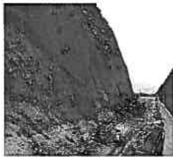
図-2 崩壊写真(H15.5撮影)
