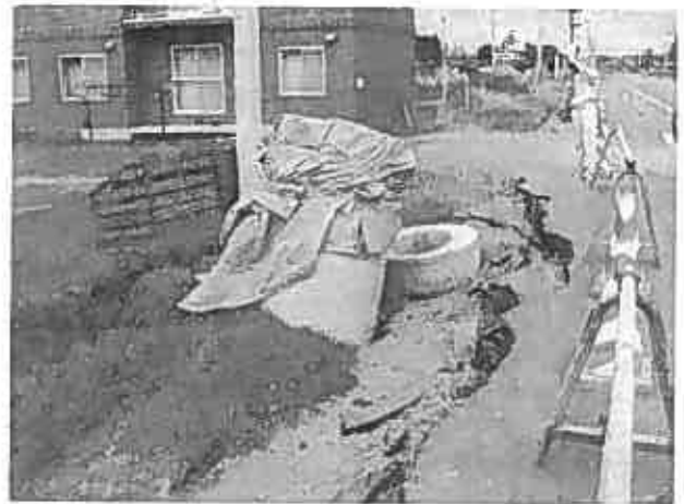
写真-2 約1.5m突出した北側のマンホール（音別町）
