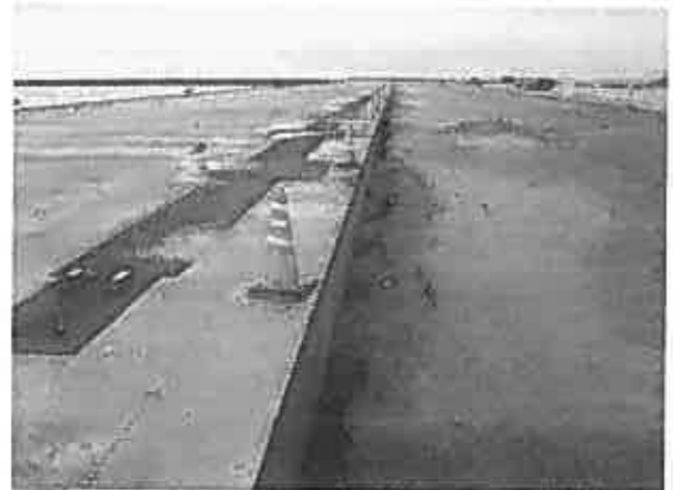
図-12 釧路港第4埠頭 段差発生
