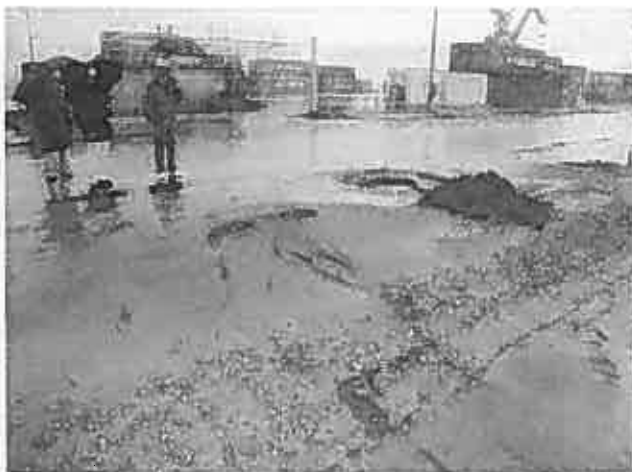
図-13 釧路港第4埠頭 周辺道路の液状化・噴砂
