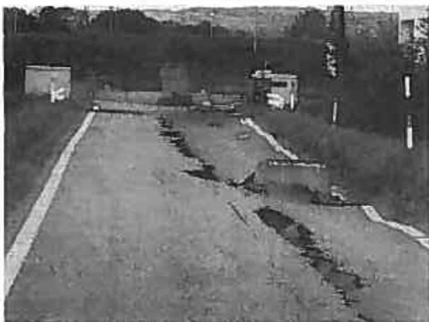
写真-6 管路埋設部の陥没状況（浄化センター地区）
