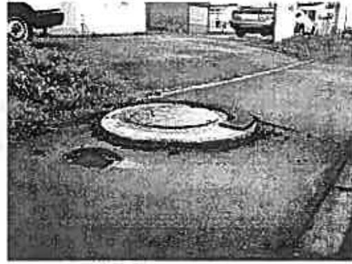
b)汚水マンホールがわずかに浮上している 地点もあった
