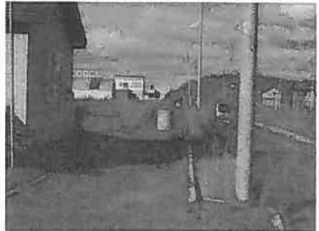
図-17 東陽団地の地盤沈下とマンホールの浮き上がり
