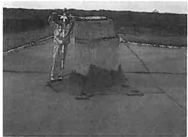
写真-5 浄化センター敷地内のマンホールの突出
