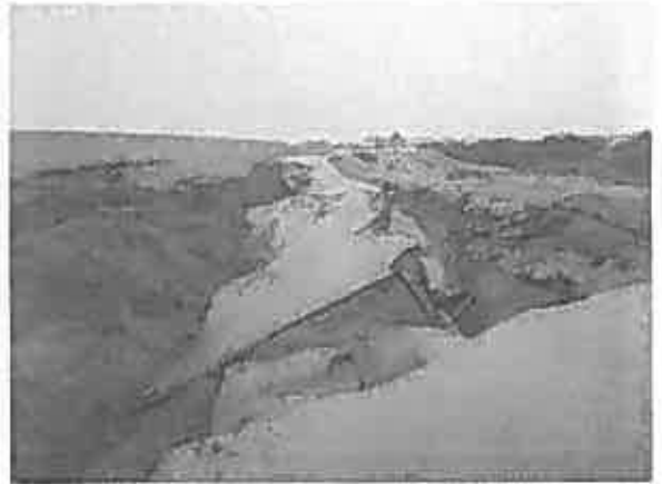
図-6 十勝川 盛土崩壊状況 大津築堤
