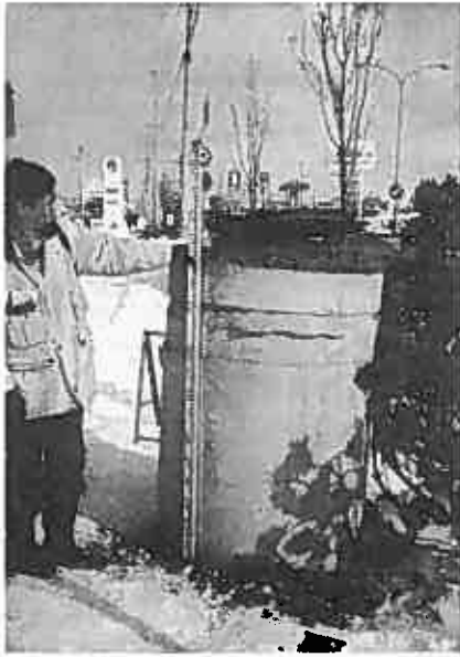
1993年釧路沖地震 マンホールが1.5m突出
