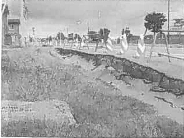
写真-3 下水道埋設箇所の陥没（約55cm 音別町）
