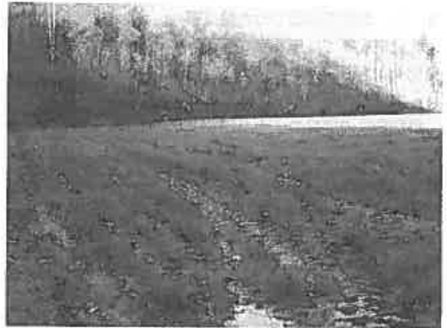
図6 端野町三区東12号での農地沈下
