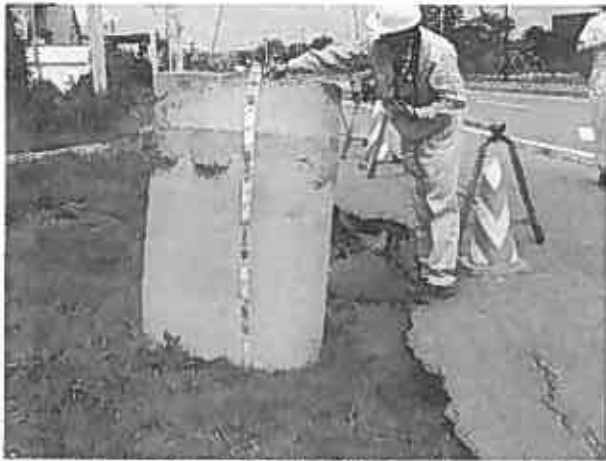
写真-1 約1.6m突出した南側のマンホール（音別町）
