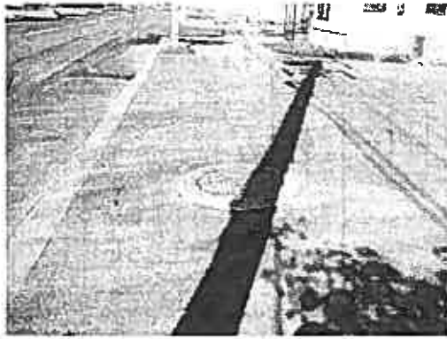
a)ほとんどの地点で無被害 (マンホール浮上や管路部の沈下は見られない)
