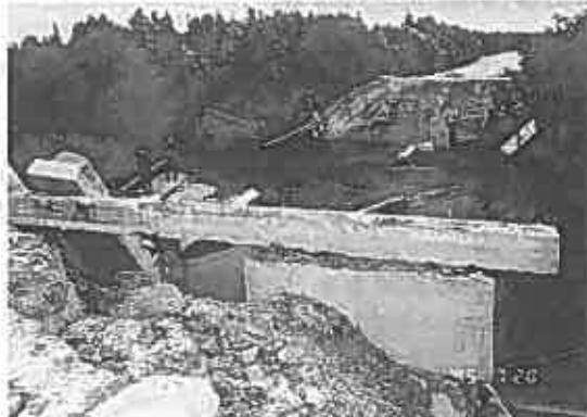
写真-6 サボ近郊の橋梁の 崩壊例
