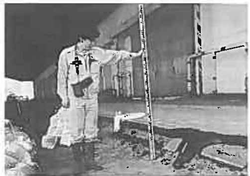
写真-2 東港漁業埠頭南側岸壁17mの沈下
