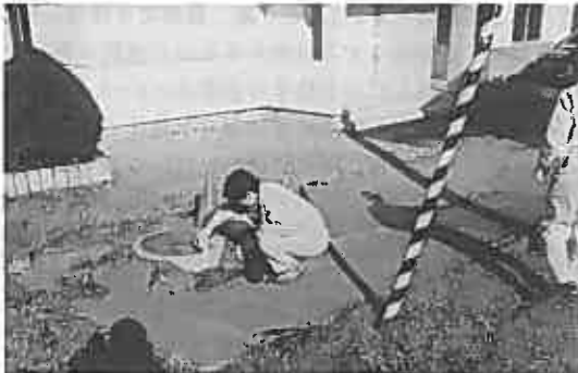
写真-4 下水道マンホールの浮上と噴砂(釧路市緑ヶ丘)
