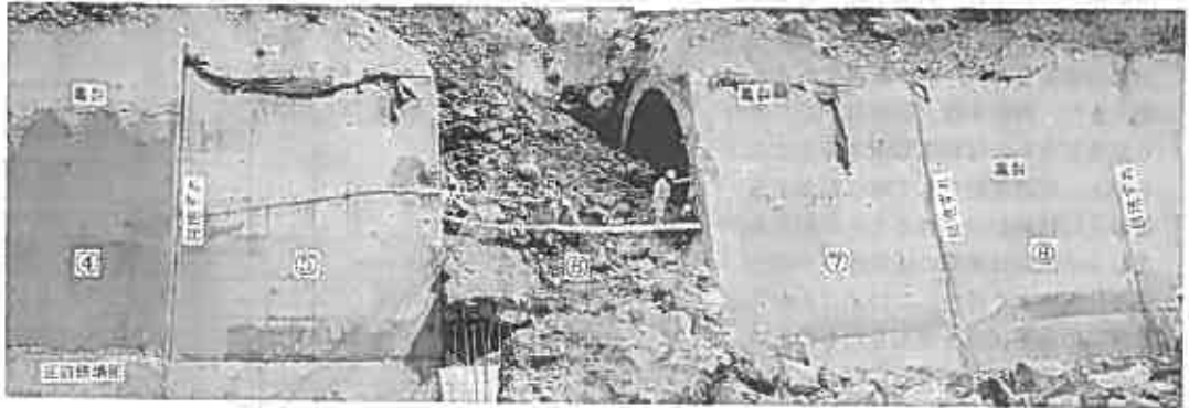
写真-3 崩壊土砂堆積および巻出し工外壁変状状況
