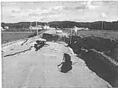
写真-3 液状化による道路の崩壊
