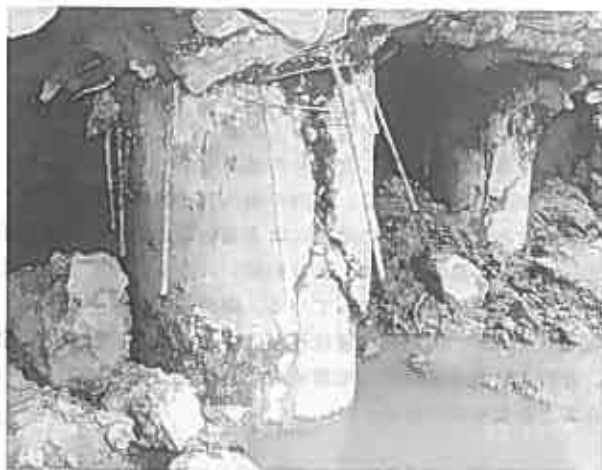
写真-2 被災したセメントサイロの PC杭の杭頭の破壊状況 (曲げとせん断による破壊)
