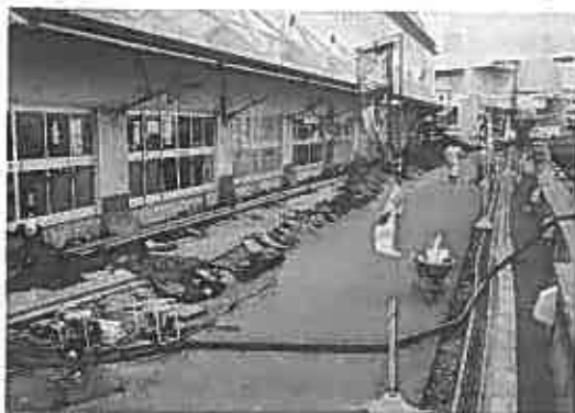
写真-2 岸壁の移動・沈下による背後地盤の埋設管の被害
