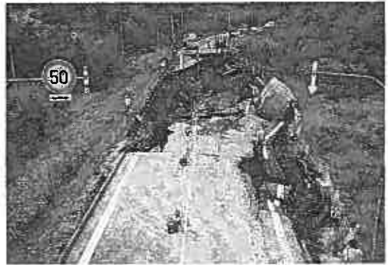
写-1 盛土崩壊直後の現場状況
