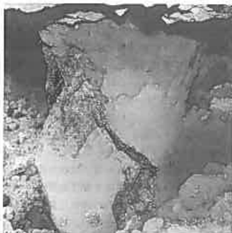
写真-4 PHC杭の杭頭の破壊状況 (曲げとせん断による破壊)
