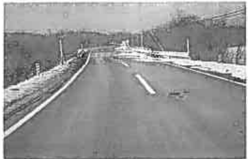
写真-2 被災パターン II型 一般道道塘路厚岸線（塘路橋取付部沈下）
