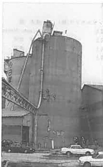
写真-1 被災したセメントサイロ (北埠頭背後地にあり、約3度の傾斜 と30~90cmの不等沈下があった。)
