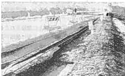
写真-3 被災パターン III型 一般道道阿寒標茶線（路肩からの 段落ちとのり面のはらみ出し）
