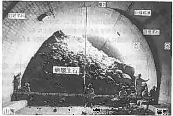
写真-2 崩壊土砂堆積状況および巻出し工部変状状況 (③ブロック付近より瀬棚側を望む)
