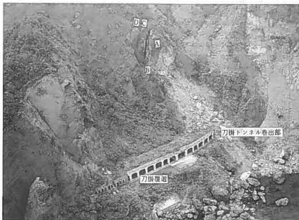
写-1 刀掛トンネル崩壊箇所全景(小樽側上空よりのぞむ)
