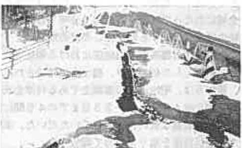
写真-4 被災パターン IV型 主要道道厚岸標茶線（車道部からの段落ち）
