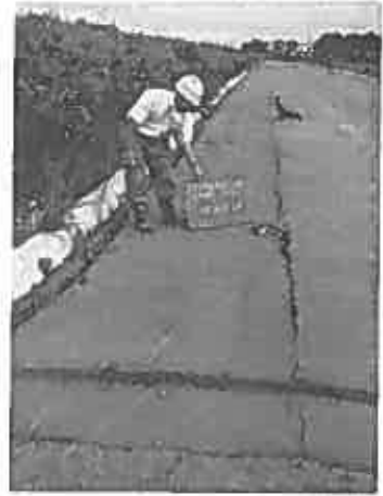
写真-3 パイルキャップ工法の変状
