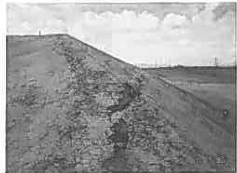
写真-6 処理部との境界に発生したクラック
