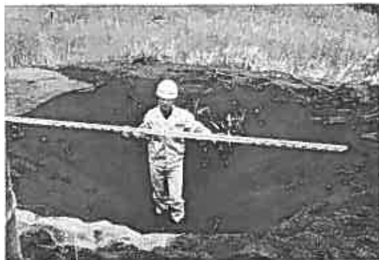
写真 1 タンピングによる沈下孔の状況
