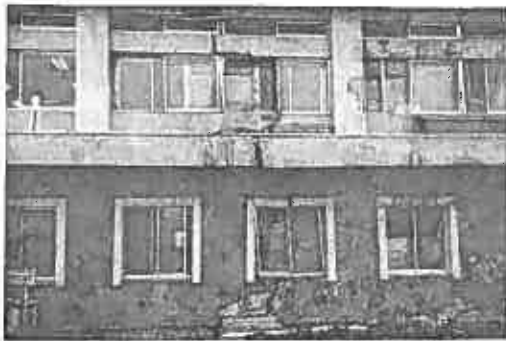
写真5 C棟北面の中央部 '81.5.26 壁面の最大亀裂中10 cm 以上
