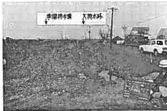
大排水路変状状況
