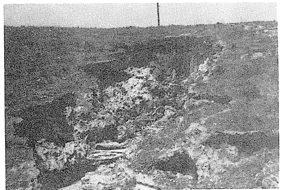
写真-1 盛土の浸食例
